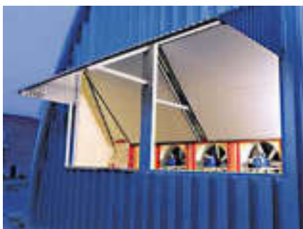
Камера смешивания (вид с улицы).
