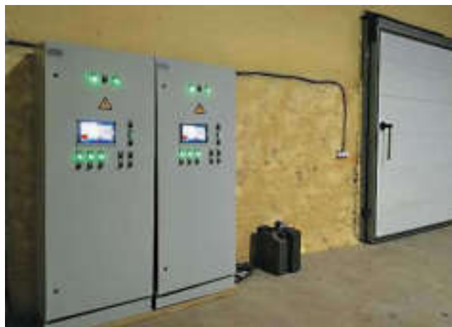
Стоящие рядом щиты управления, подключить к Интернету проще.
