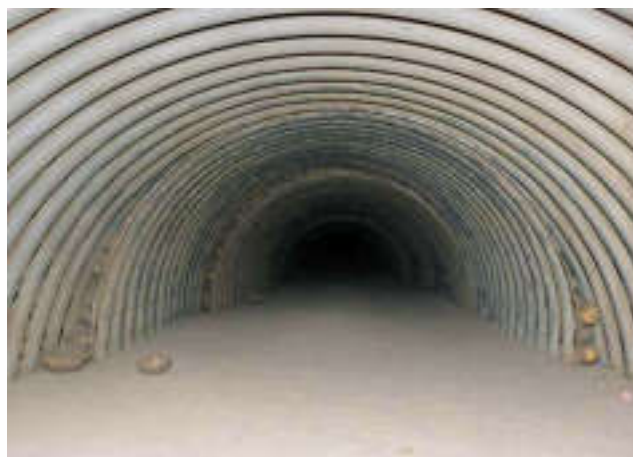
Вентиляционный канал, собранный из модулей (вид изнутри).
