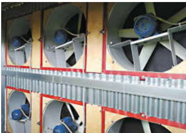
Напорные вентиляторы оборудованные обратными клапанами.
