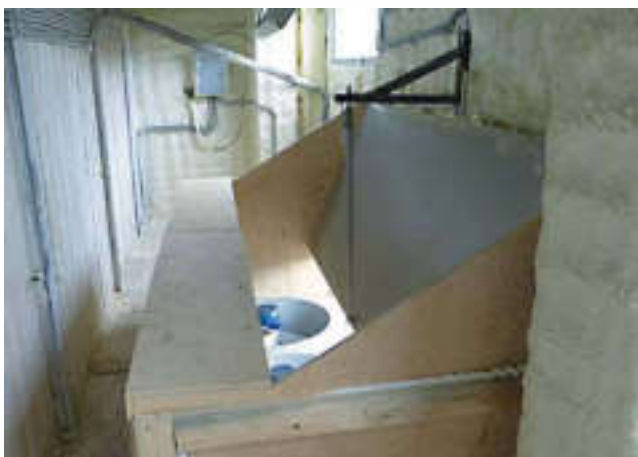
Открытый на 50% приточный клапан, благодаря обустроенной камере, смешивает воздух из хранилища и с улицы.
