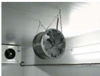
Противоконденсатный (разгонный) вентилятор.
