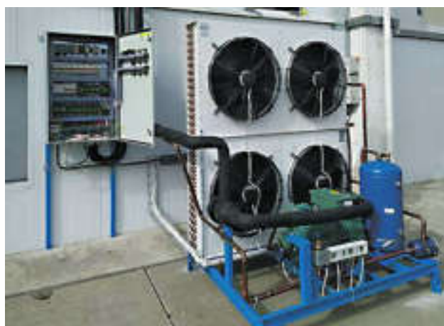
Компрессор, испаритель и щит управления холодильной машины.
