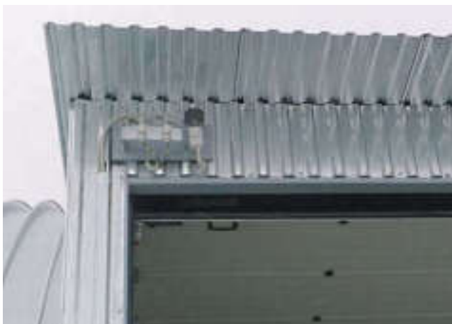
Уличные датчики температуры и влажности на северной стороне.
