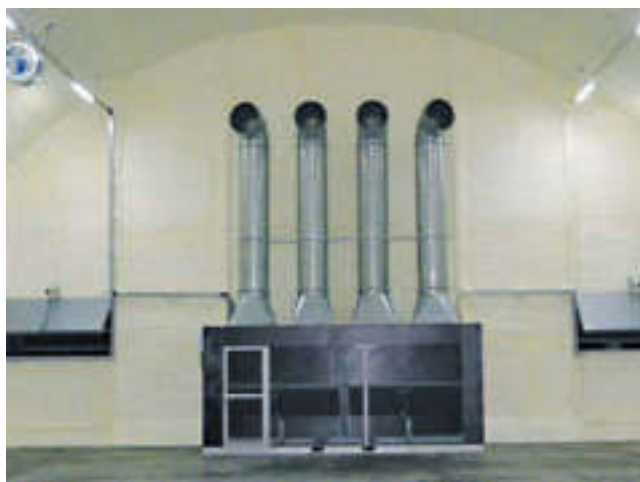
Овощехранилище, оборудованное модульной воздухосмешивающей камерой (МБК) – «VENTOGLAS™ 04K5».
