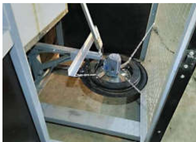
Установленный в модульной венткамере увлажнитель воздуха.
