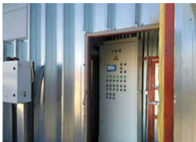
Щит управления VENTOGLAS™ установлен в специальном помещении.
