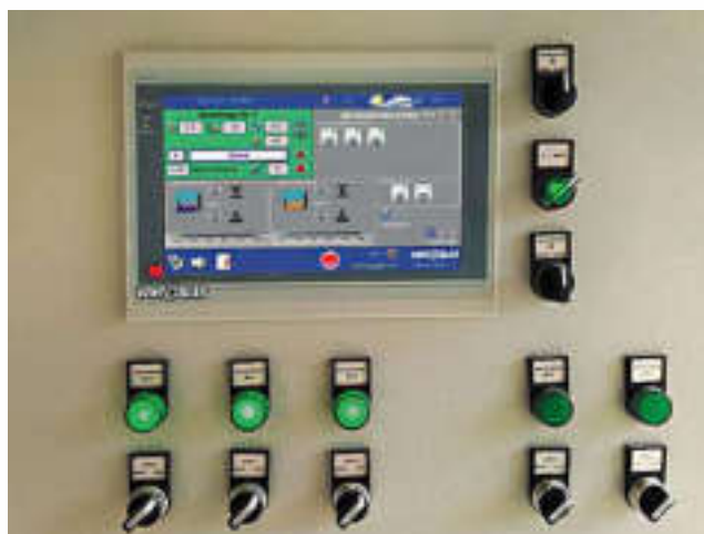
Панель управления вентиляционной системой «VENTNOGLAS™».
