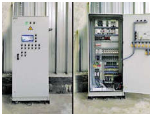
Блок управления вентиляцией картофелехранилища – «VENTOGLAS™» (справа этот же блок, но с открытой дверцей).
