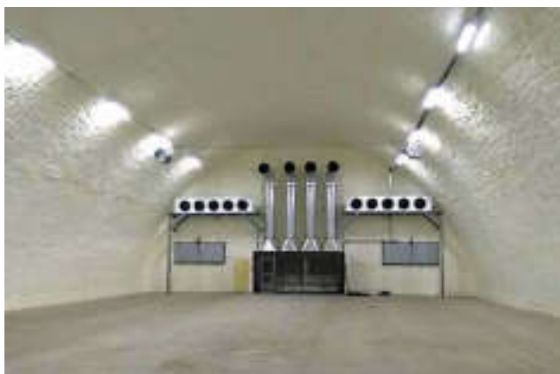
Установка пространственной вентиляции с холодильной машиной, охладители которой установлены выше уровня контейнеров.
