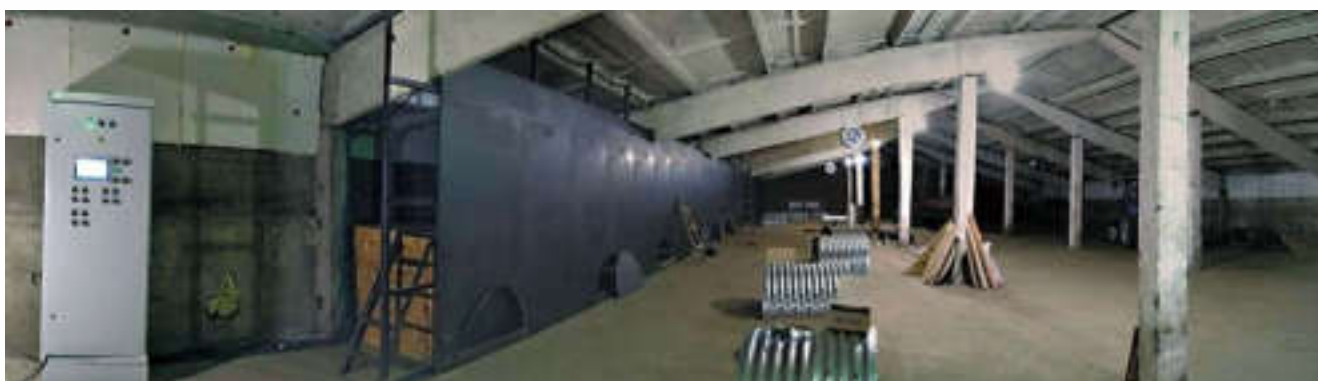
Реконструированное овощехранилище навального типа, оборудованное двухканальной вентиляционной системой «VENTOGLAS™ 04H5». Горномарийский район, Республика Марий Эл.
